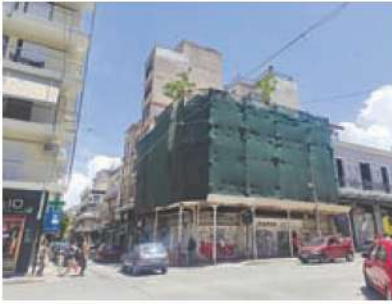
❶ Οδός Πούναρη: Δέντρα έχουν φυτρώσει στο εσωτερικό του εγκαταλελειμμένου κτιρίου
