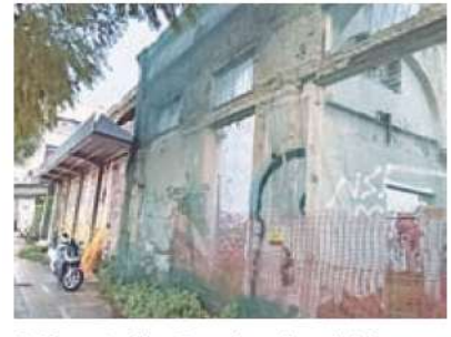
❸ Οθωνος Αμαλίας: Ένα ακόμη κτίριο-σύμβολο της εγκατάλειψης, σε έναν από τους πιο κεντρικούς δρόμους της Πάτρας
