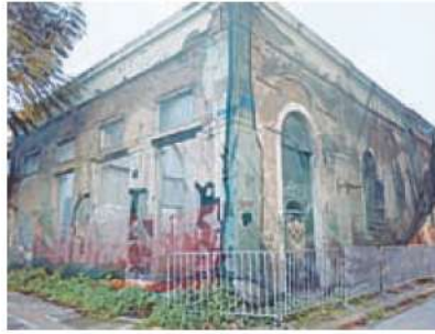
❷ Στην εγκατάλειψη και την φθορά πολλά κτίρια στην οδό Αγίου Ανδρέου
